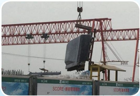
改进前：用专用吊具吊装模板时，模板因重心偏移发生倾斜，存在坠物安全隐患
